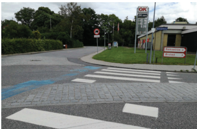
Eksempel på fodgængerkrydsning på Ramsøllevej, hvor der mangler 0-lysning (rampe) til fortov samt retnings- og opmærksomhedsfelt.
