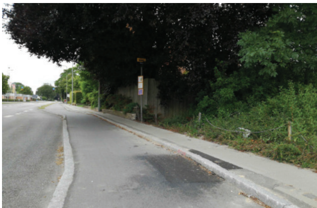
Eksempel på manglende rampe mellem fortov og cykelsti ved bussens midterdør.
