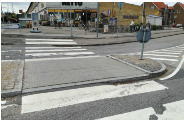
Det sydlige fodgængerfelt på Møllehusvej, hvor rampen er for stejl og belægningen ujævn
