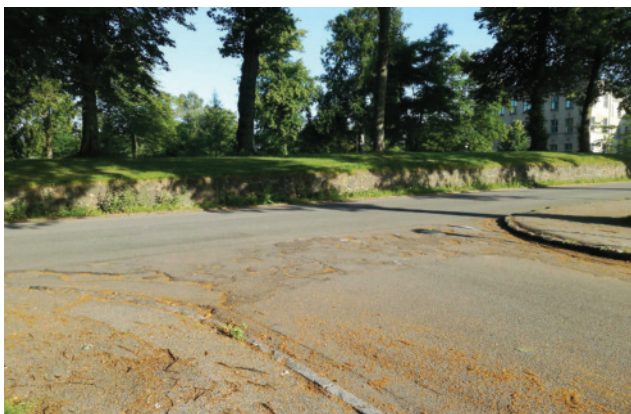
Eksempel på nedslidt belægning i krydset mellem Søndre Allé og Bistrup Bakke
