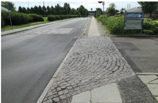
Eksempel på ujævn overkørsel på Ollerupvej, hvor ledelinjen forsvinder.
